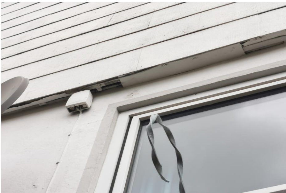
Abb. 12 Exemplarische Einflugöffnung unter Holzverschalung (Front)
