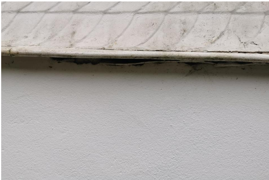
Abb. 14 Beispielhafte Mauerritzen (tief)
